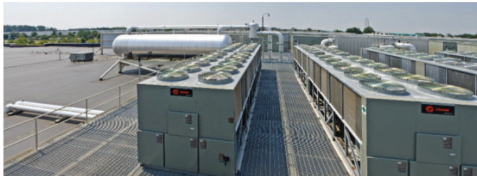
SAVVIS DATA CENTER - IRVINE, CA
